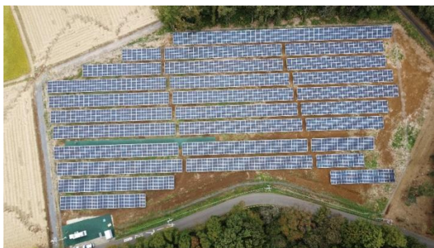
茨城県茨城町太陽光発電所 (設備容量 : 1,050kW)
