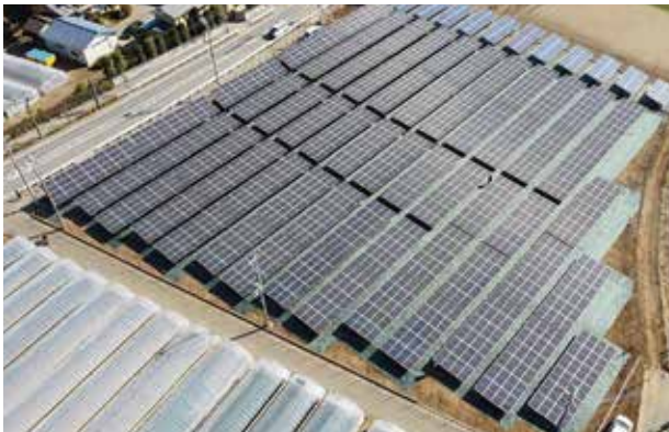
野田木間ヶ瀬太陽光発電所 642.88kW
