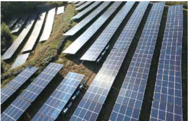
美里白石太陽光発電所 580.32kW
