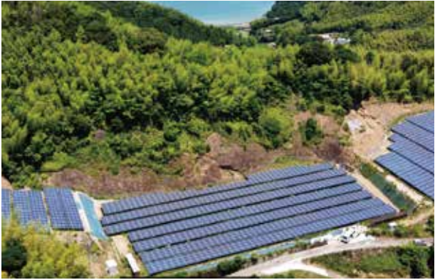
阿波福井太陽光発電所 698.88kW
