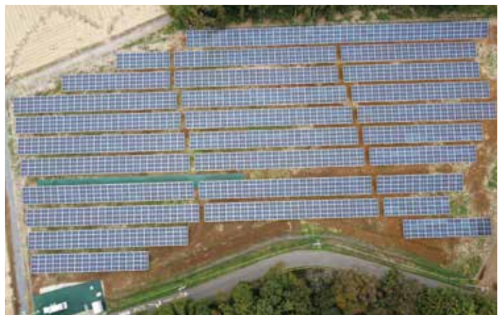
茨城県茨城町太陽光発電所 1MW
