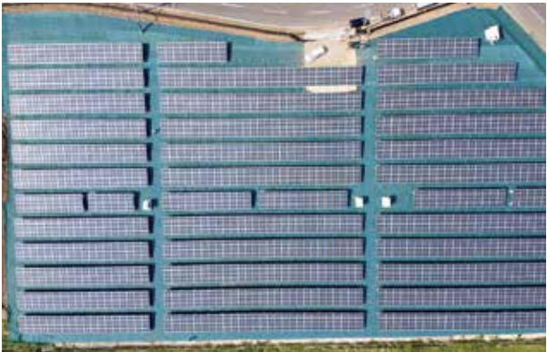
長崎県田平町太陽光発電所 1.03MW
