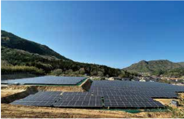
山口県下小鯖太陽光発電所 974.7kW
