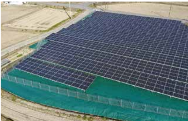
加西市福住太陽光発電所 302.6kW
