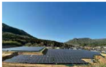
山口県下小鯖太陽光発電所 974.7kW
