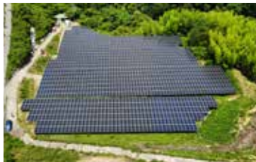
淡路岩屋発電所 1.09MW
