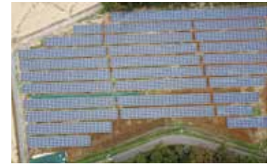
茨城県茨城町太陽光発電所 1MW
