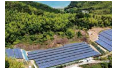
阿波福井太陽光発電所 698.88kW
