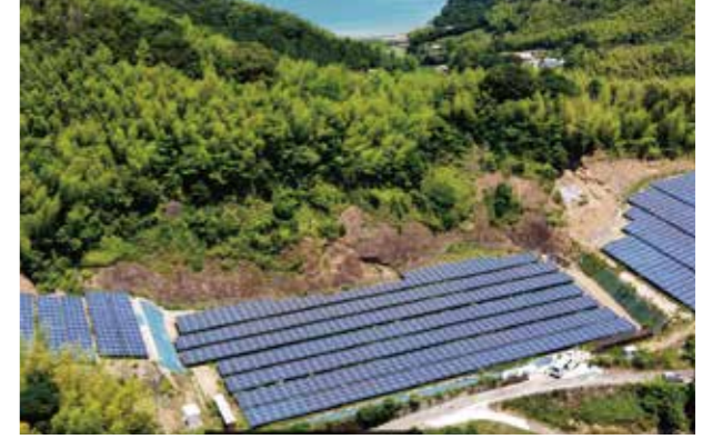
阿波福井太陽光発電所 698.88kW
