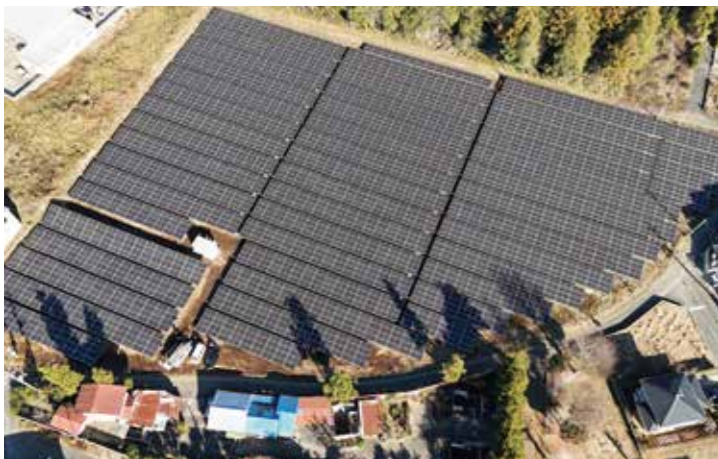
リープтон茨城町小幡発電所 1.59MW
