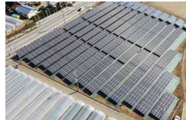
野田木間ヶ瀬太陽光発電所 642.88kW
