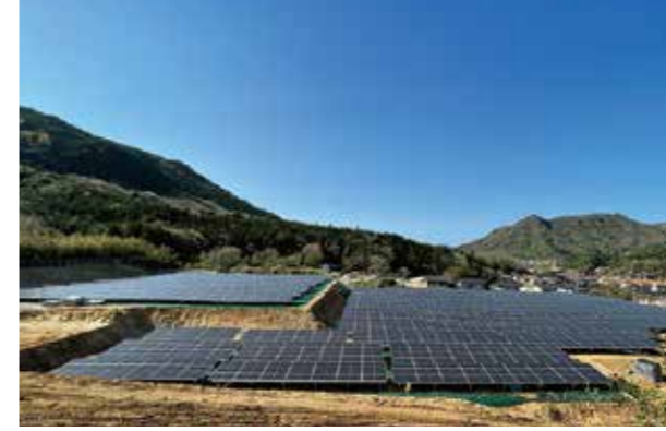
山口県下小鯖太陽光発電所 974.7kW
