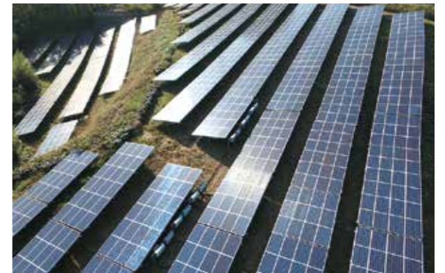
美里白石太陽光発電所 580.3kW
