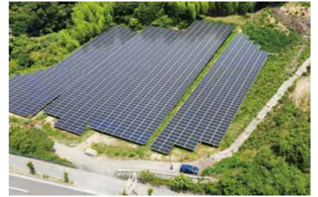
淡路市岩屋字桑ノ木谷発電所 1.09MW
