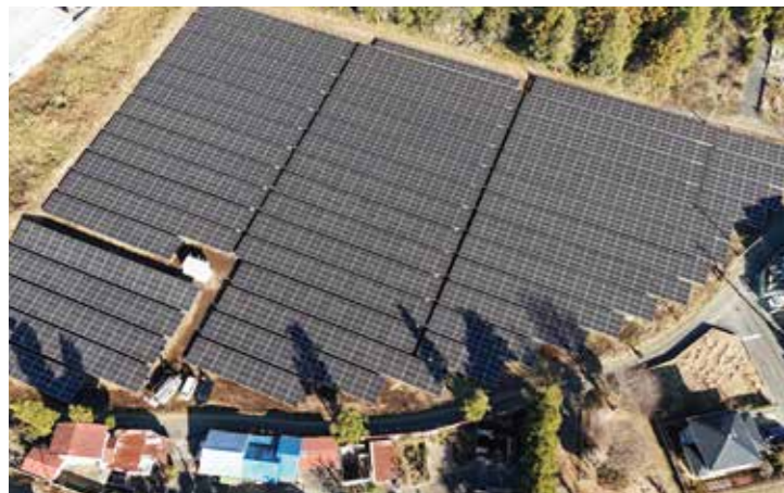
リープトン茨城町小幡発電所 1.59MW
