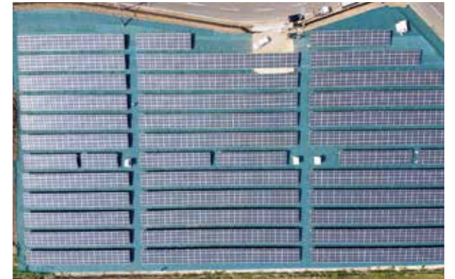
長崎県田平町太陽光発電所 1.03MW
