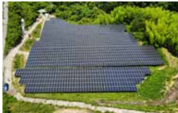
淡路岩屋発電所 1.09MW
