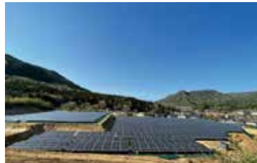
山口県下小鯖太陽光発電所 974.7kW
