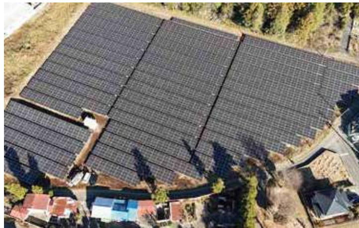
リープтон茨城町小幡発電所 1.59MW
