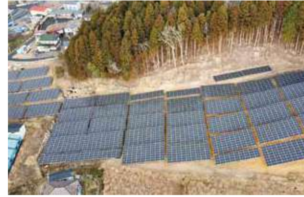
LP宮城県石巻太陽光発電所 1.35MW
