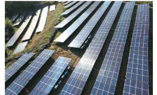
美里白石太陽光発電所 580.3kW
