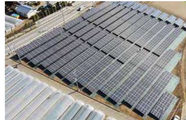
野田木間ヶ瀬太陽光発電所 642.8kW
