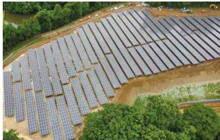
滑川町山田太陽光発電所 1.87MW
