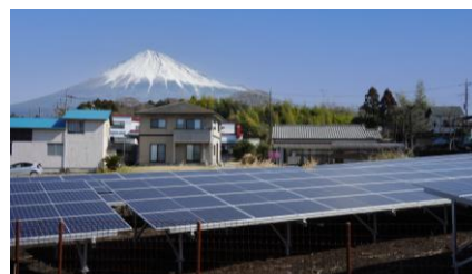
静岡富士宮発電所 | 255.2kW
