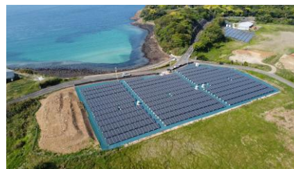
長崎平戸発電所 | 1MW
