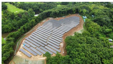
埼玉滑川発電所 | 1.8MW
