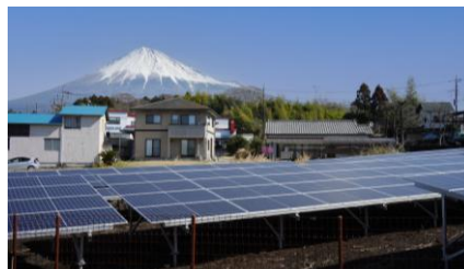
静岡富士宮発電所 | 255.2kW
