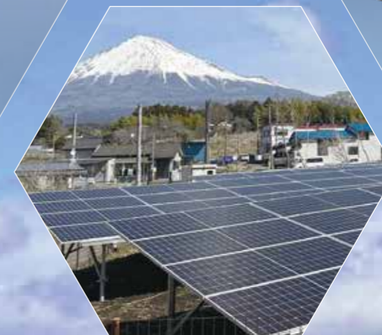
自社太陽光発電所の設置、 管理、メンテナンス
