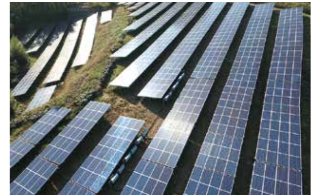
美里白石太陽光発電所 580.32kW
