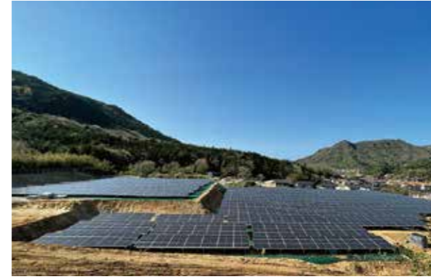
山口県下小鯖太陽光発電所 974.7kW
