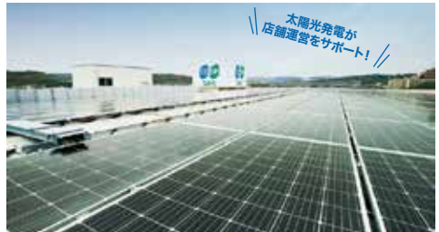
リープтонエナジーが4年を要し、太陽光発電による自家消費を行っている「コープエナジー神戸」の屋根に設置された「L156*156-A6-60」12枚を併設設置の自立型で設置、合計発電容量は22.33kW。
