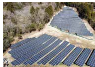
滋賀甲賀発電所 | 651.9kW
