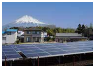
静岡富士宮発電所 | 255.2kW
