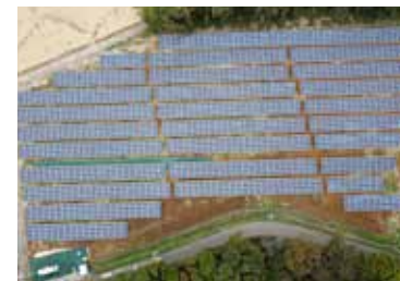
茨城中石崎発電所 | 1MW
