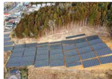
宮城石巻発電所 | 1.3MW
