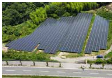
兵庫岩屋発電所 | 1MW
