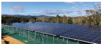
志摩太陽光発電所 75.2kW
