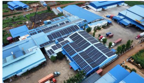
Đồng Nai, 900kwp
