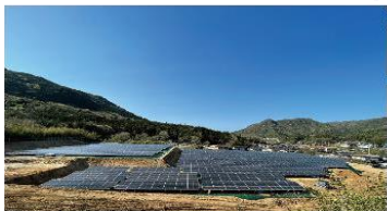
山口県下小幡太陽光発電所 974.7kW
