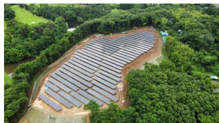
埼玉滑川発電所 | 1.8MW
