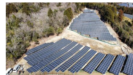
滋賀甲賀発電所 | 651.9kW
