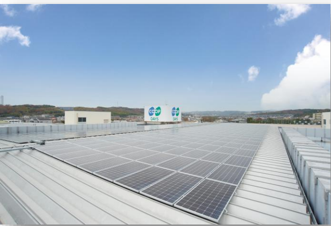
設置場所：コープデイズ神戸西店（兵庫県神戸市） 出力規模：158.4kW 使用パネル：LP156*156-M-72-360W
