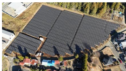
茨城小幡発電所 | 1.5MW
