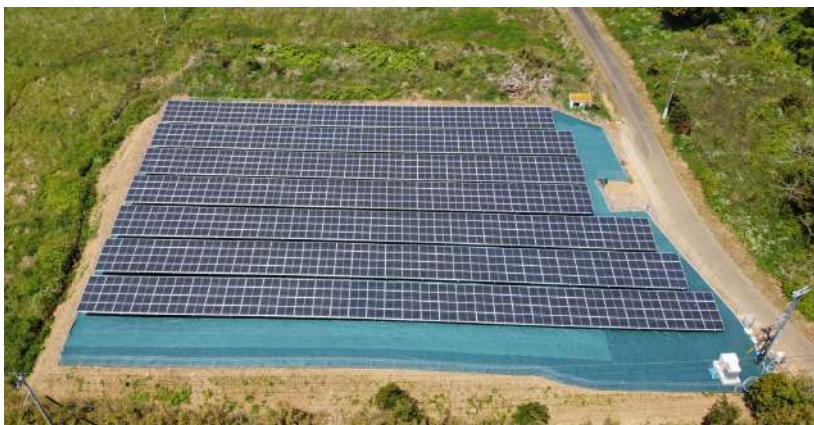
▶リープтон長崎県田平町大久保太陽光発電所/282.88kW
