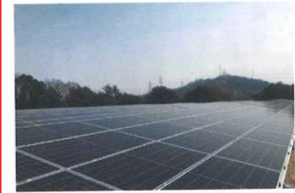
リープтонエナジーのオンサイトPPA事業の第1号案件。航空機部品生産協同組合(三重県松阪市)の敷地内にパネル出力738kWの太陽光発電設備を設置した
